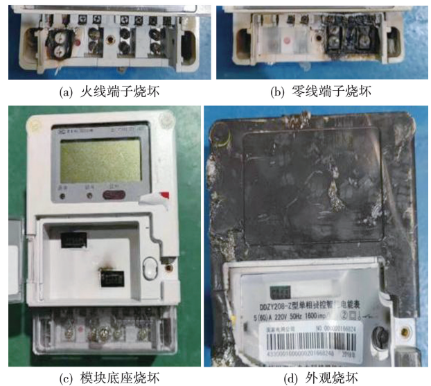
图 1 烧表损坏的智能电能表实物照片
